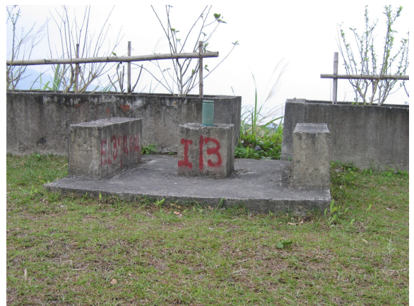
每個月進行的邊坡穩定安全監測儀
